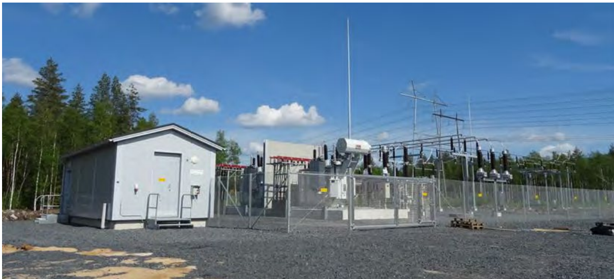
Kuva 45. Esimerkki tuulivoimapuiston sähköasemasta (Oltava, Pyhäjoki).
