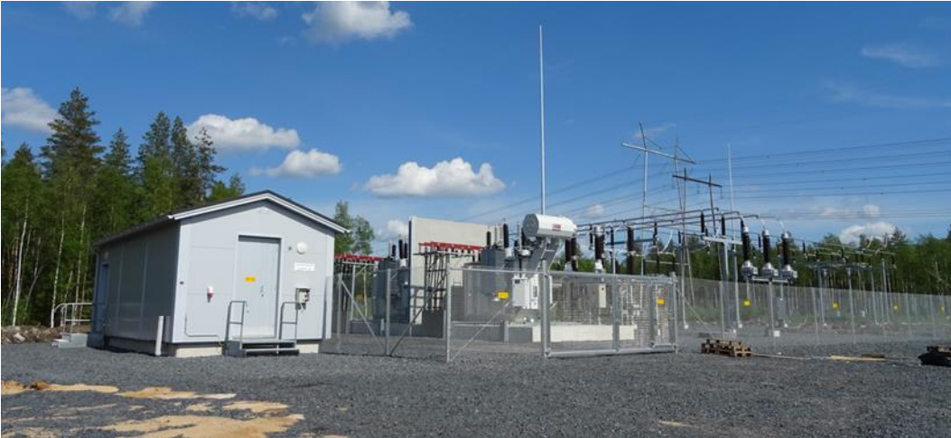
Kuva 10. Esimerkki tuulivoimapuiston sähköasemasta (Oltava, Pyhäjoki).
