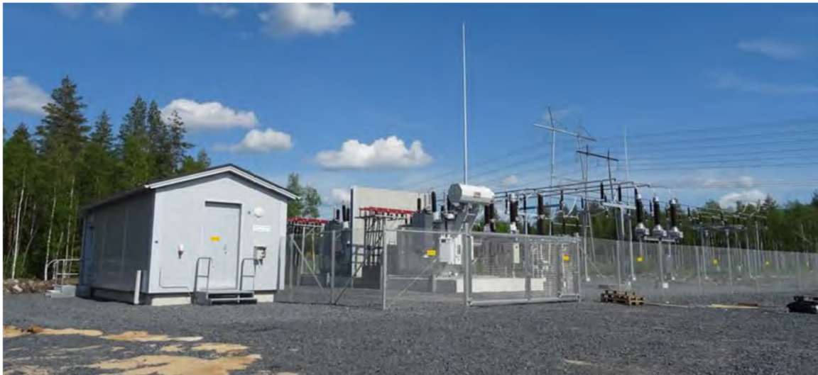
Kuva 50. Esimerkki tuulivoimapuiston sähköasemasta (Oltava, Pyhäjoki).
