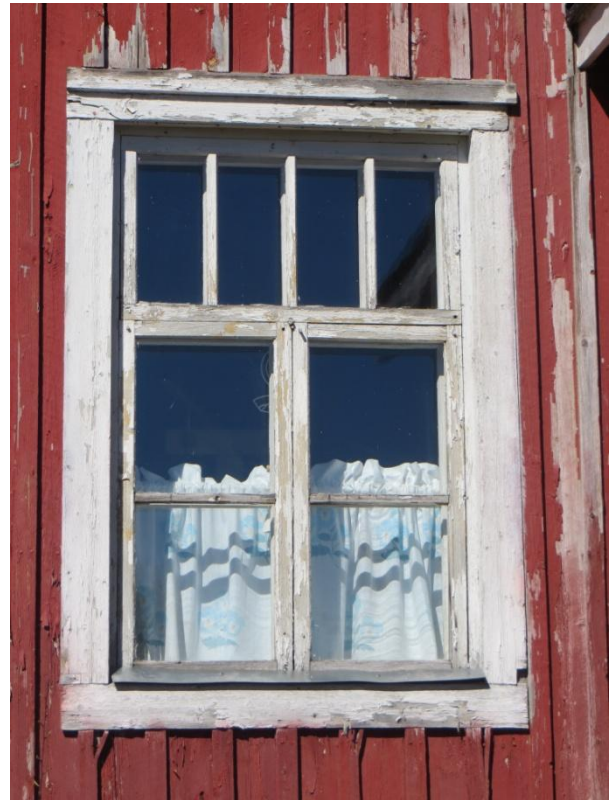
Kuva 16. Puistolan vuonna 1929 rakennetun asuinrakennuksen ikkuna.
