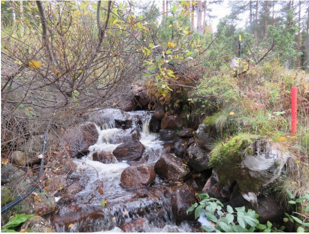
Mylly 1, sortunut perustus ja pohjapato (alareunassa).
